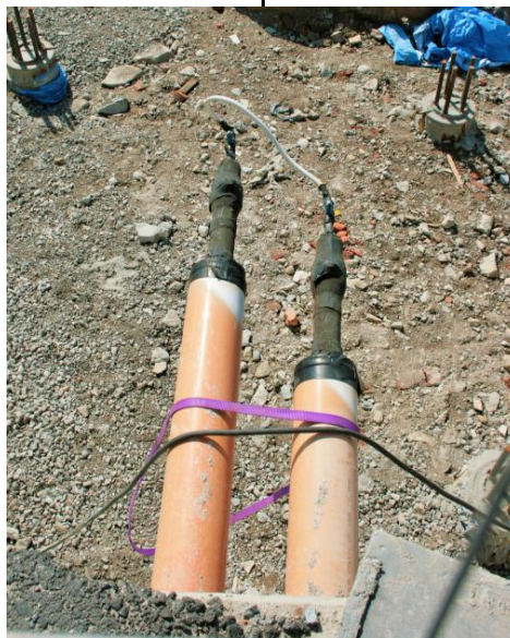
Teknisk avsättning tillgänglig för anslutning.
