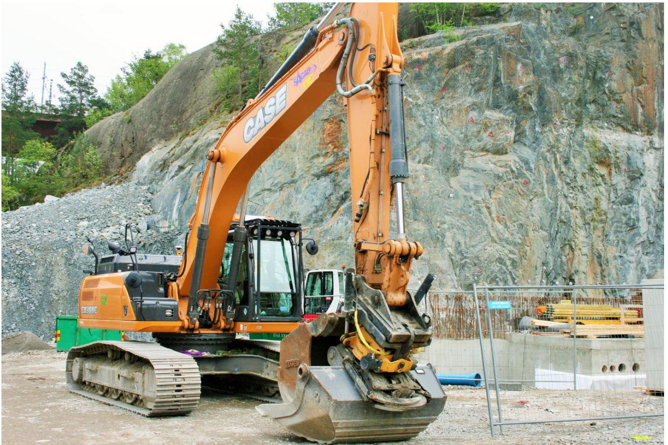
Ifall tunga maskiner finns på arbetsplatsen ökar arbetsmiljörisken.
