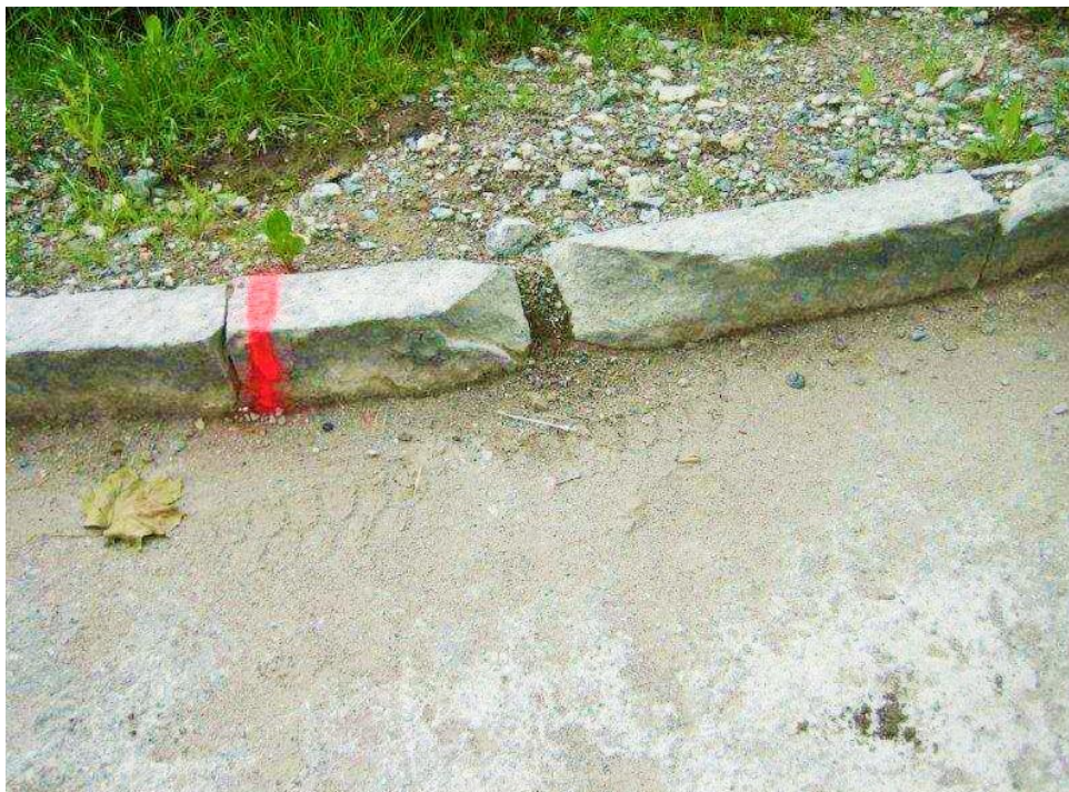
Skador och slitage från byggtrafik på exempelvis kantstenar är en risk om finplaneringsarbeten färdigställs i ett tidigt skede.
